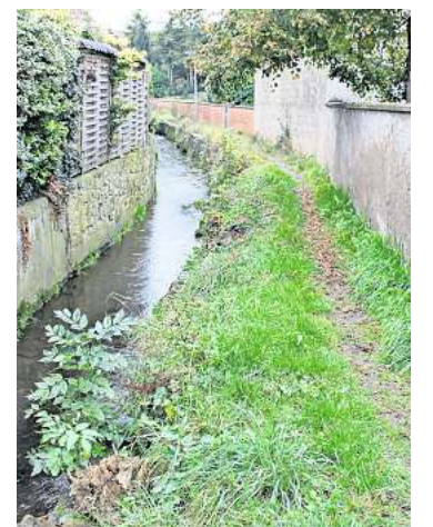
Die Ufermauer entlang der Beeke in Jeinsen muss saniert werden. FOTO: TOBIAS LEHMANN
